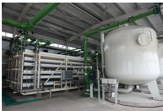
清净废水回用单元的一部分
